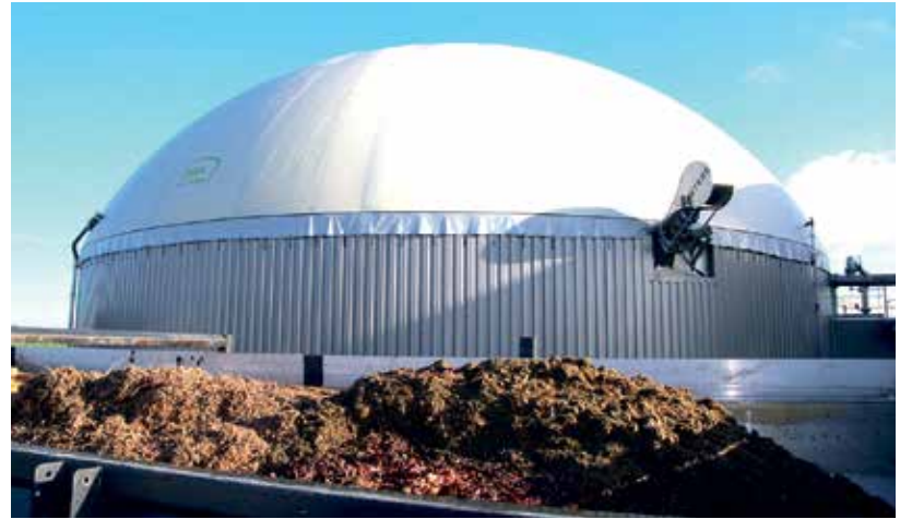
200 tonnes de matières transformables sont envoyées chaque jour vers le digesteur à l'arrière-plan
